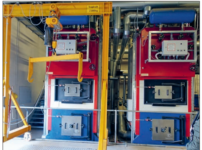
Die zwei Holzöfen in Erfurtshausen. Sie laufen einzeln oder zusammen, je nach Bedarf.
