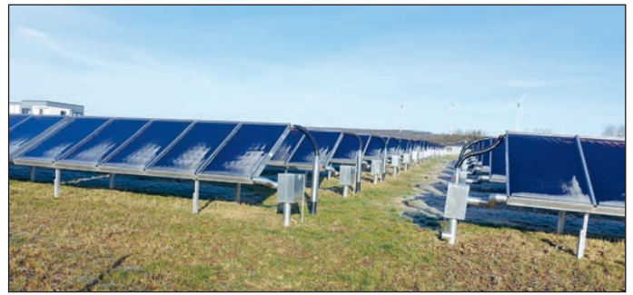
Sonnenkollektoren, 12. Februar 10 Uhr, Außentemperatur +2°C, Sonnenschein, liefern schon Wärme, weshalb der Brenner auf Teillast läuft
