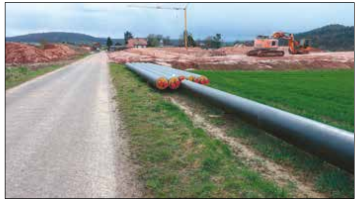
Die Hauptverbindung Siedlung-Bracht dient zunächst der Wasserbefüllung des Speichers und später dem Wärmetransport zwischen den Ortsteilen.
