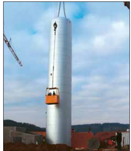
Der Speicher wurde mit zwei Kränen aufgerichtet, auf der Bodenplatte verankert und zuletzt an den Transportlöchern verschlossen. er ist 20 cm stark gedämmt.
