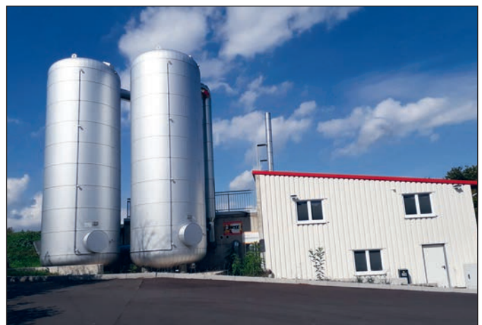
Das moderne Holzhackschnittel-Heizwerk in der Kernstadt
