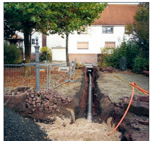
Die Genossenschaften – wie hier in Schwabendorf – verlegen die Nahwärmeanschlüsse der Mitglieder bis zum Haus. Bild: Eva Hawig
